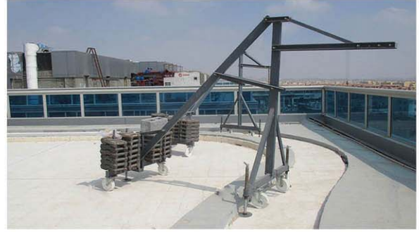
مجموعة ثابتة أو متحركة على السطح Fixed or Mobile suspension roof System
